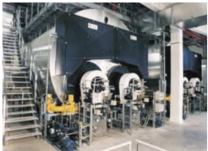
4 kotły wodne wysokotemperaturowe dwupłomienicowe UNIMAT UT-HZ zainstalowane w jednej kotłowni. Każdy o mocy 23 000 kW.
