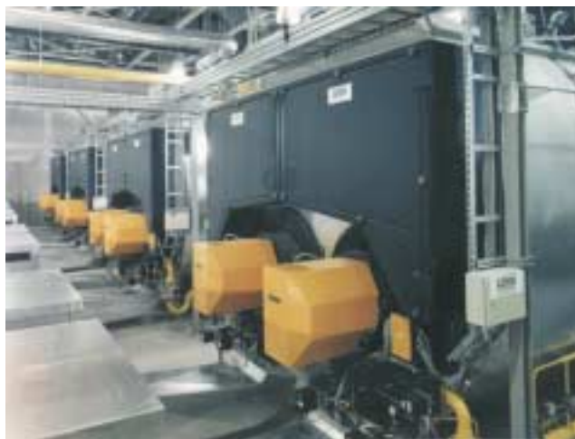
4 kotły dwupłomienicowe UNIVERSAL ZFR produkujące parę nasyconą. Wydajność instalacji 120 000 kg/h o ciśnieniu 16 bar.
