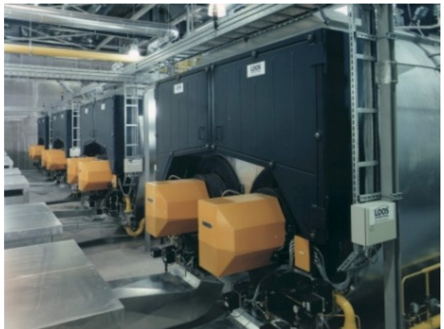
Vier Zweiflammrohr-Rauchrohrkessel UNIVERSAL ZFR für 120 t/h Dampfleistung in einer Papierfabrik
