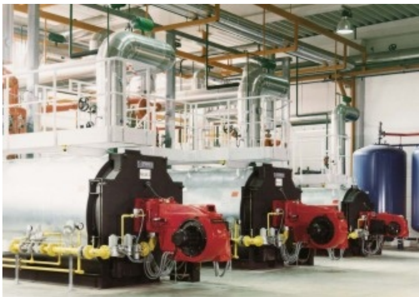
Rys. 1: Niskociśnieniowy trójciągowy kocioł wodny zainstalowany w ciepłowni
