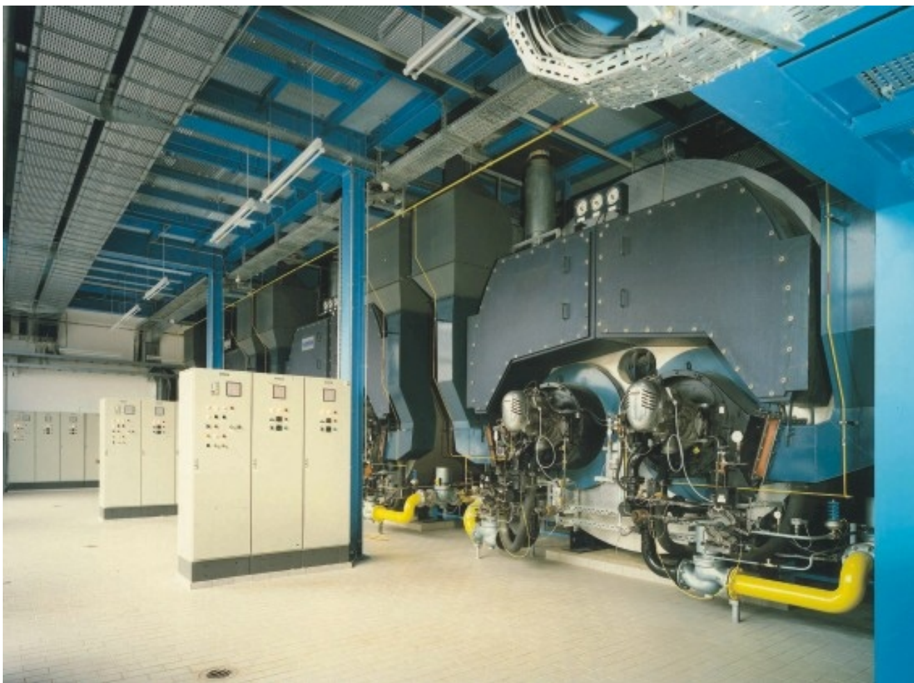
Rys. 2: Trzy wysokociężeniowe kotły wodne, dynamicznie współpracujące w jednej instalacji
