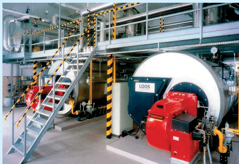
Rys. 1 Nowoczesna kotłownia parowa
