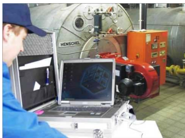
Bezproblemowe przejęcie serwisu kotłów marki Henschel przez techników obsługi klienta firmy LOOS
